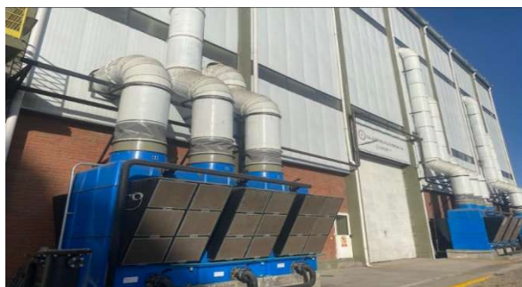
Imagen de la instalación de ventilación adiabática para Usina.
