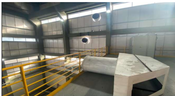
Sala de máquinas: Piezas sin montar para culminar proyecto de ventilación adiabática.
