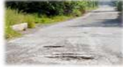
Rotura de calles
