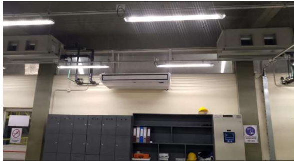
Sala de operación: Evidencia climatización central y localizada. Tiene regulación de temperatura.
