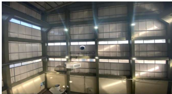
Sala de máquinas: Instalación faltante de ventilación adiabática, ver proyecto en anexo.
