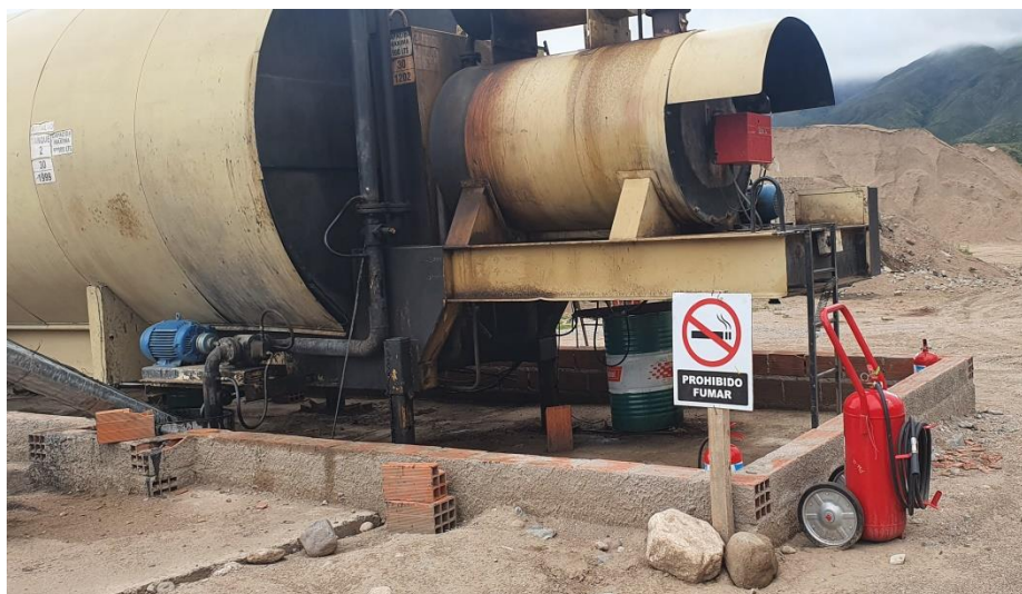
Imagen N° 39: Tanque de Full Oil de la planta de asfalto.
