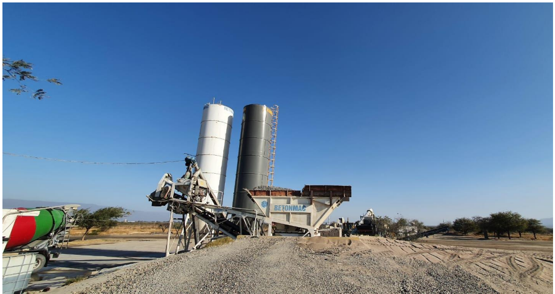
Imagén N° 16: Limpieza del tamis de la tolva, riesgo de caídas y golpes con herramienta manual.
