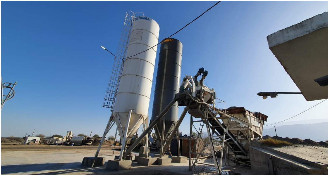
Imagén N° 15: En la tarea de la carga de los silos la exposición a inhalación de cementos, golpes por el latigo del conducto.
