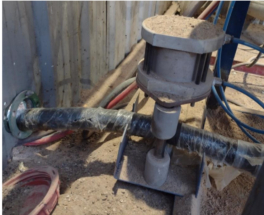
Imag.3 (Control a distancia de la Tolva)
