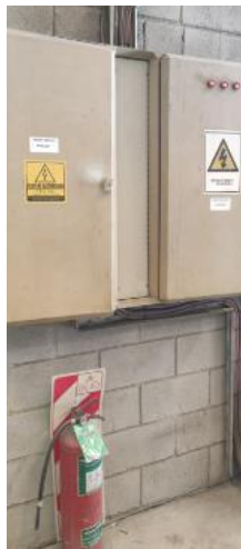
Extintor descargado en 1° galpón
