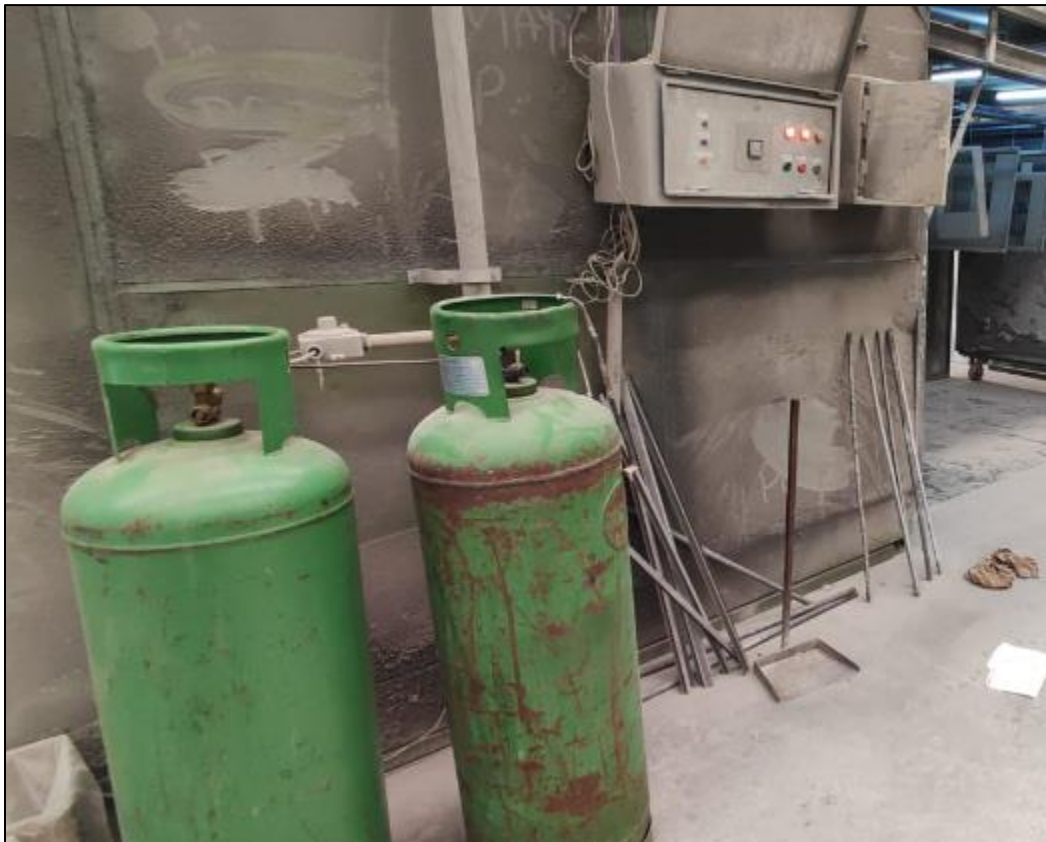
Tubos de gas envasado
