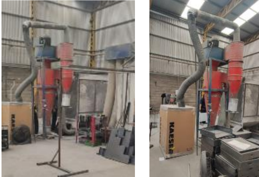
Sistema de extracción precario
