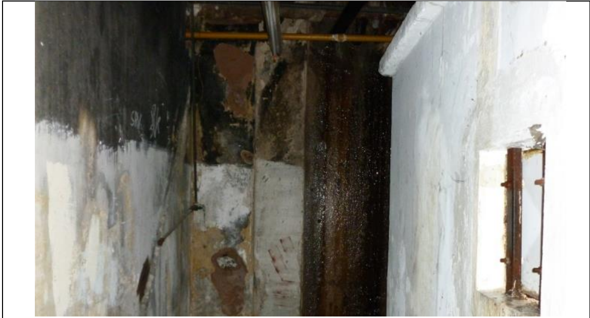
Foto: 3 Costado de la cisterna, pared contraria presenta humedad
