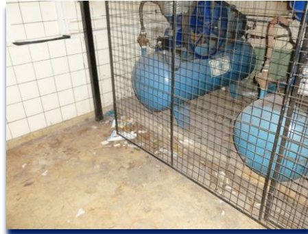
Foto: Lugar donde se encuentran los compresores de la institución
