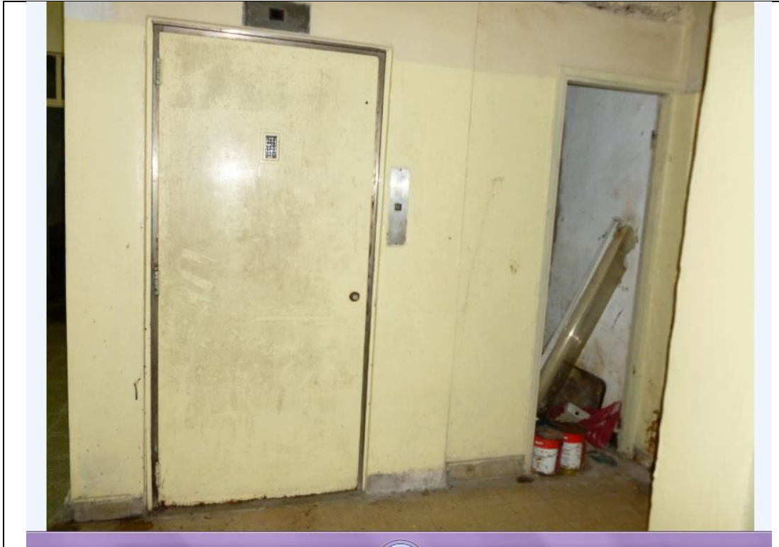
Foto 7: Puerta del ascensor y al lado un espacio con resto de latas de pintura
