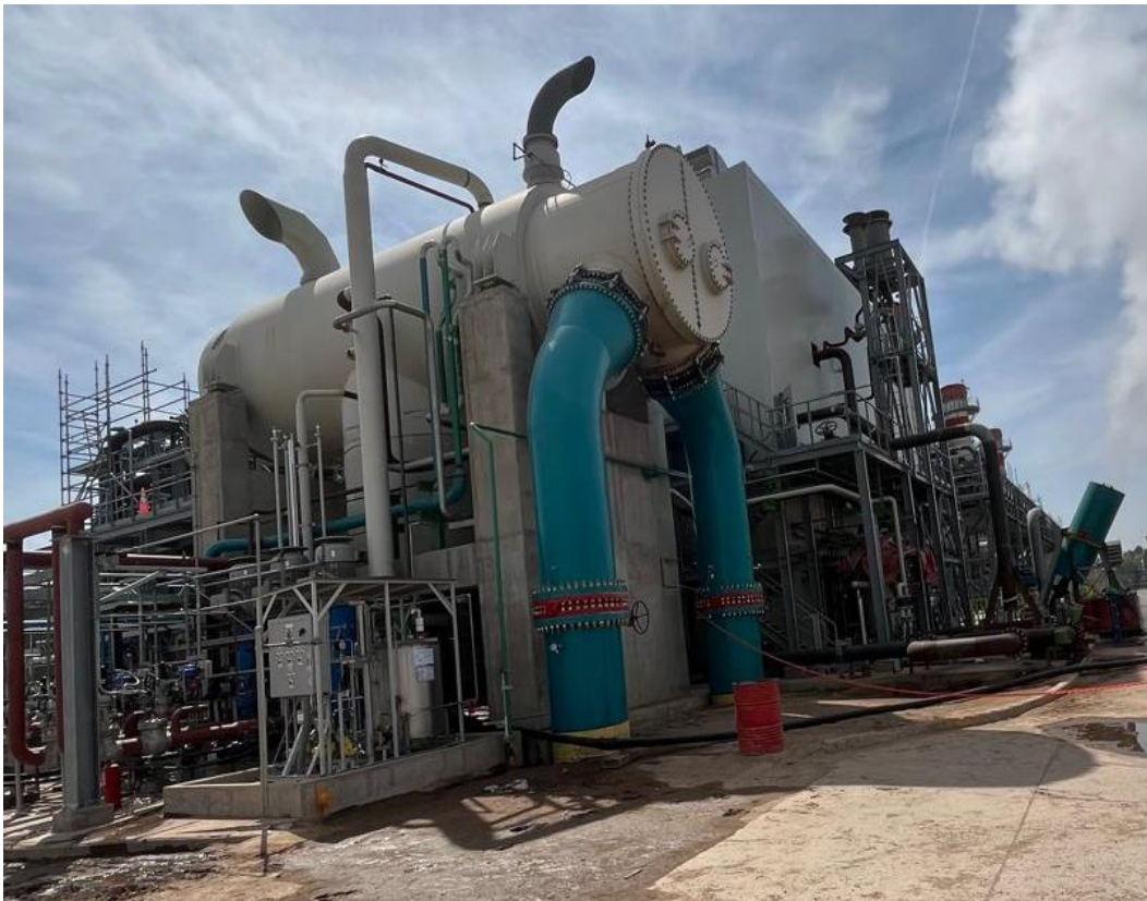
Turbina de vapor en funcionamiento
