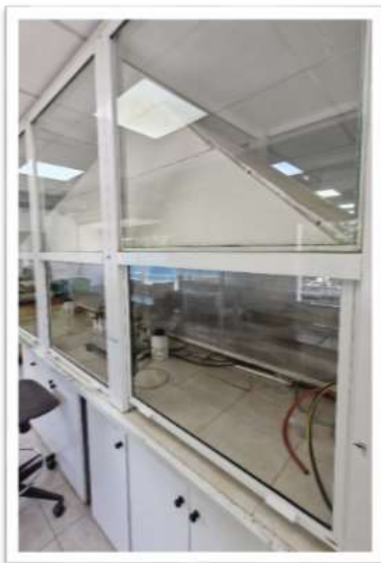
Ilustración 33 - Falta de marcas y/o topes
