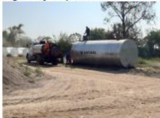
Fig.15: Regadora y tanque de almacenamiento
