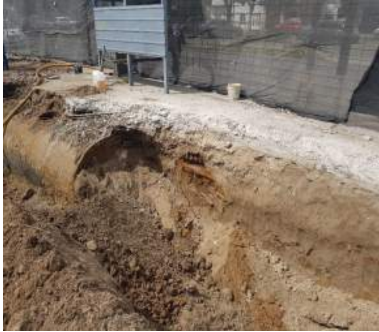
Ilustración 50: Imagen del tanque N° 4 y líneas de tendido municipal. (Fuente: CPC MsaA)
