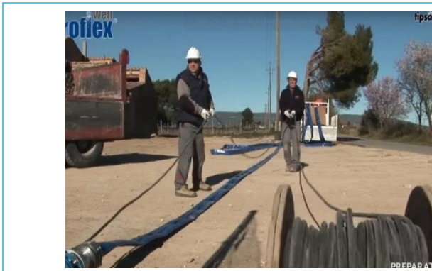
Instalación eléctrica Trifásica
