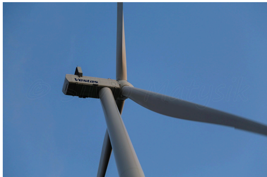
Figura I. Aerogenerador Vestas V 150-4,5 MW.
