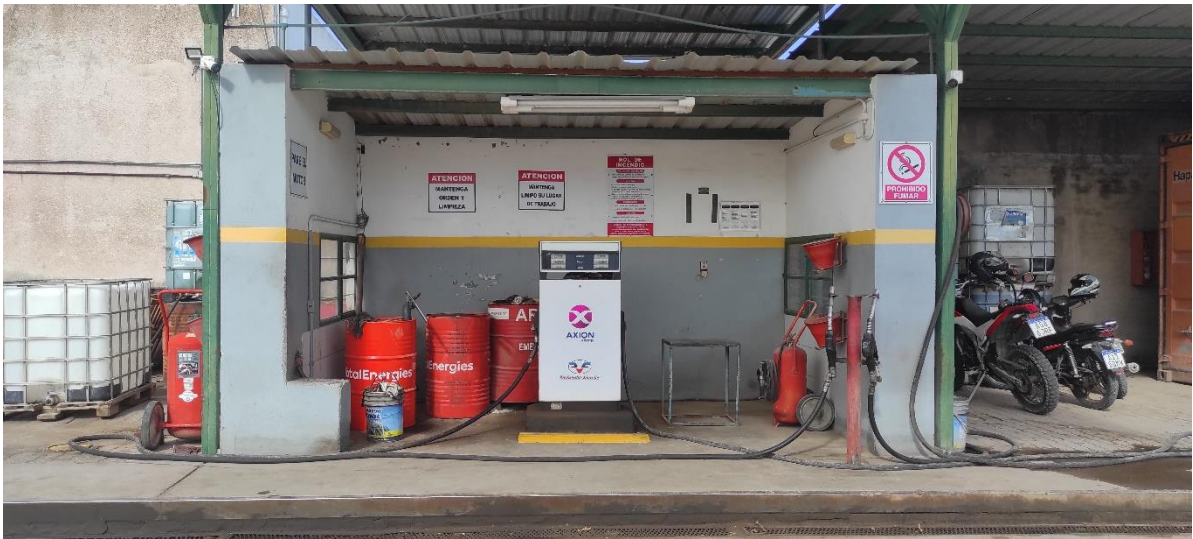
Sector despacho de combustible
