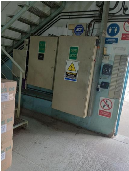
Fotografía nº 2: al ingresar a la Nave Principal del Establecimiento, se disponen la acometida de energía eléctrica, tableros principales y secundarios con sus correspondientes protecciones.
