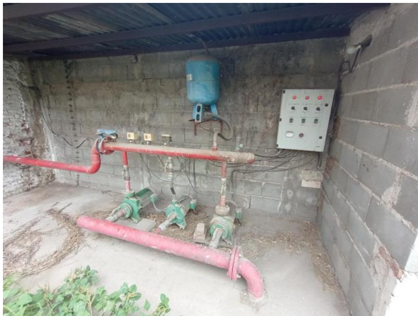
FOTOGRAFIA nº 8: en esta fotografía se puede observar el “Equipo de Bombeo”. Conformado por dos electrobombas principales, una jockey o recalque. Pulmón de aire, presostatos, manómetro que indica la presión del
