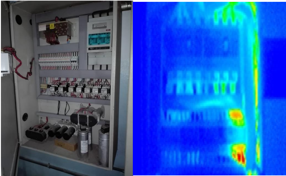
Fotografía 3: Tablero Secundario nº 1, máquinas inyectoras. Tablero, dispositivos maniobra y protección – conductores. Temperatura normal.
