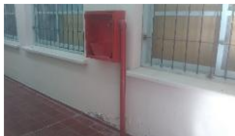
Foto N° 10: Gabinete de hidrante, sin manguera instalada.
