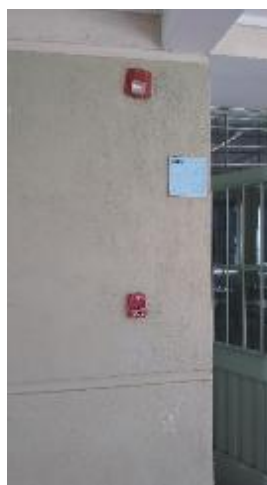
Foto N° 14: Pulsador y sirena con señal lumínica.
