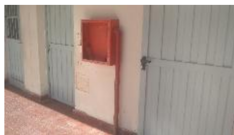
Foto N° 12: Gabinete de hidrante, sin manguera instalada.
