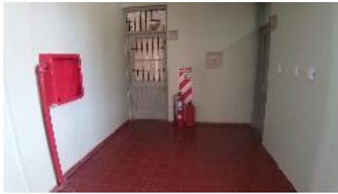
Foto N° 15: Gabinete de hidrante, sin manguera instalada.
