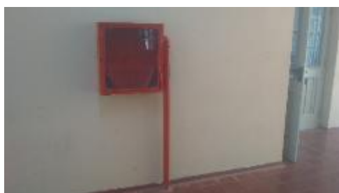
Foto N° 11: Gabinete de hidrante, sin manguera instalada.
