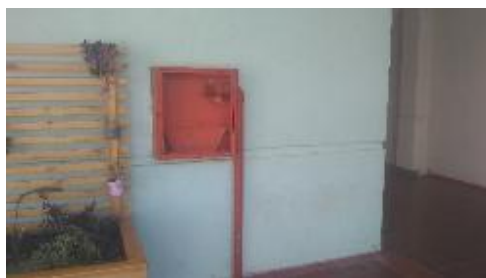
Foto N° 9: Gabinete de hidrante, sin manguera instalada.
