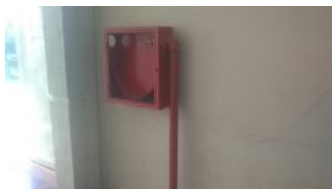
Foto N° 13: Gabinete de hidrante, sin manguera instalada.
