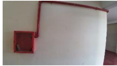
Foto N° 16: Gabinete de hidrante, sin manguera instalada.
