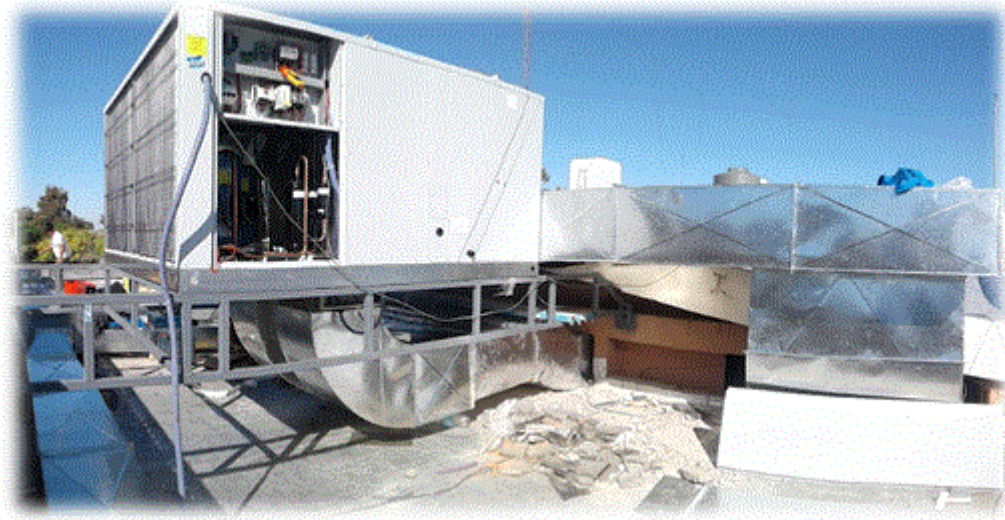
Climatización industrial trabajo realizado por JAF
