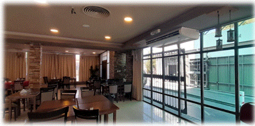
Climatización confort trabajo realizado por JAF
