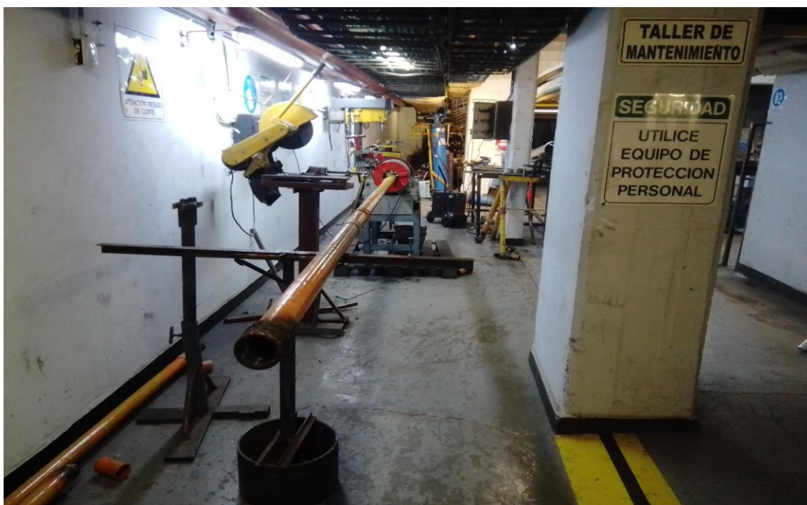
Foto 4 - Taller de Herrería / Distribución de máquinas en espacios reducidos
