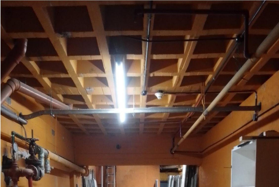
Foto 9 - Taller de Carpintería / Sist. de Prot. Contra Incendios - Detección y Extinción.
