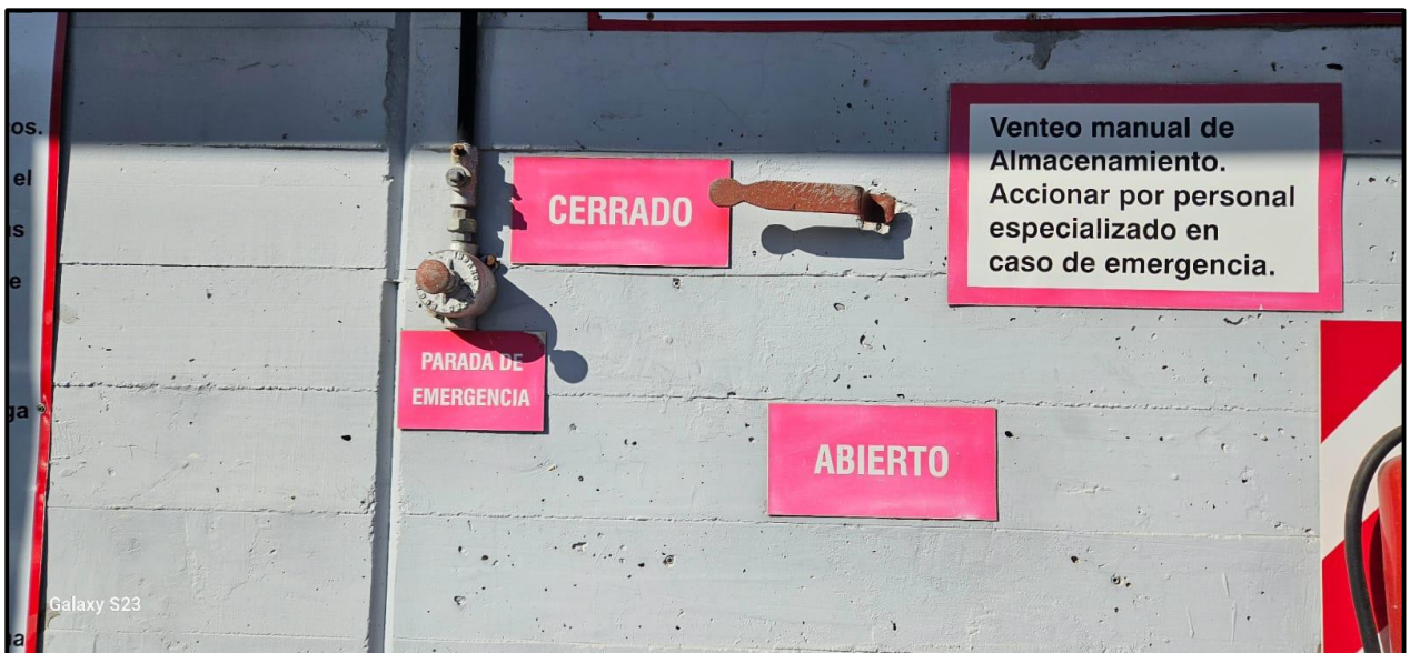
Botón de parada de emergencias de planta compresora.
