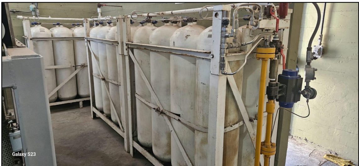
Betería de almacenamiento de GNC
