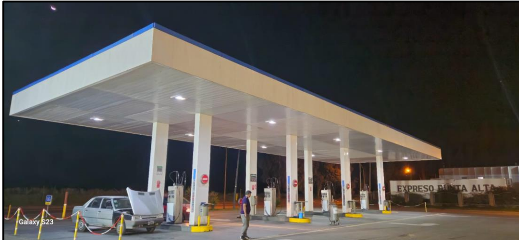
Distribución de luminarias en playa de GNC.
