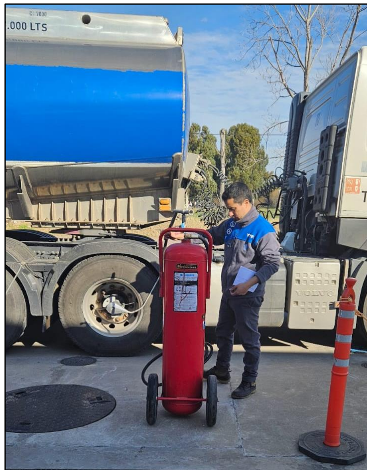
Ubicación del Extintor tipo carrito de 70 kg.
