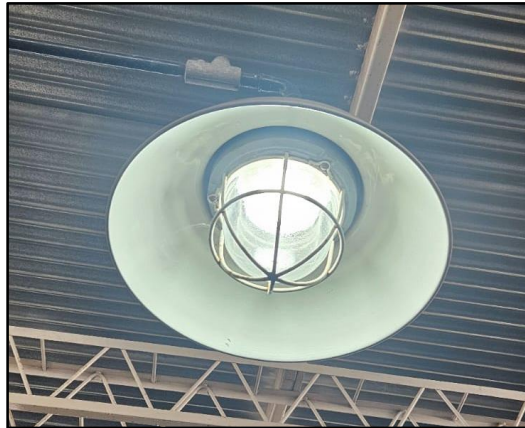
Sistema de iluminación antiexplosivo
