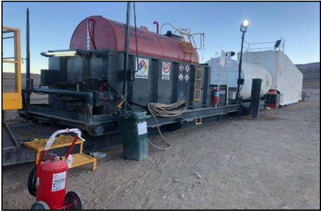
Tanque de Gas-Oil
