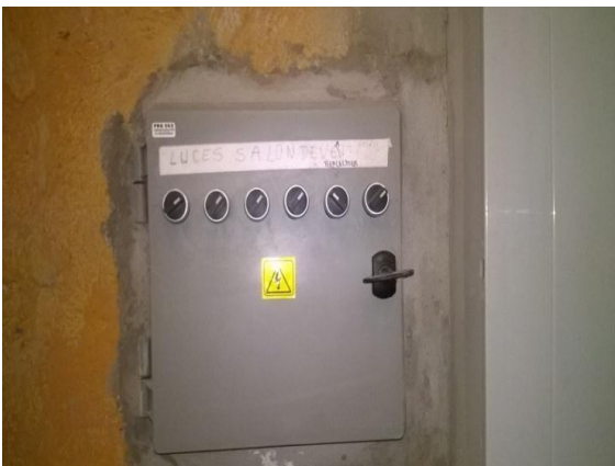
Fotografía tapa y contratapa del tablero.
