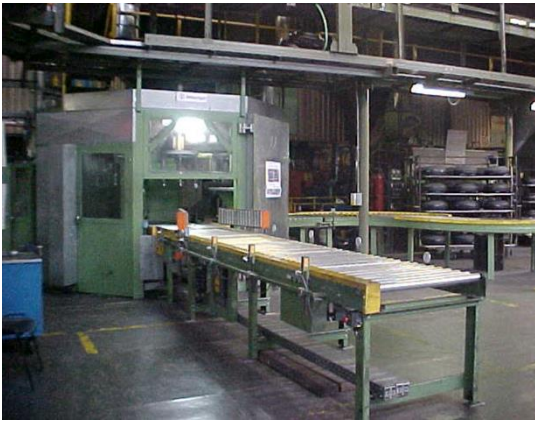
Cabina de pintura n°5
