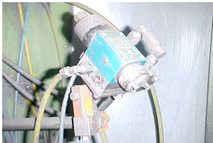
Pistola neumática que realiza el atomizado automático de la pintura
