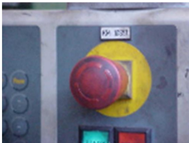
Imágen N° 23 Pulsador de parada de emergencia
