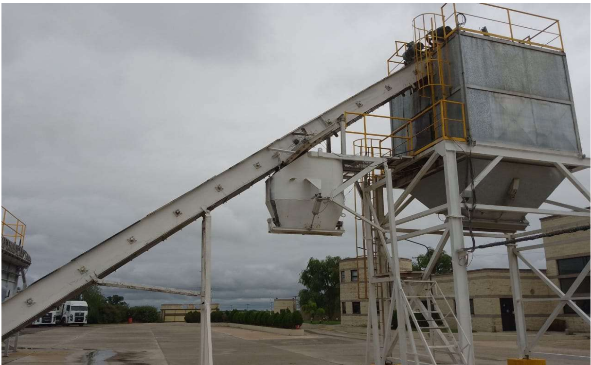
Fuente de ruido numero 3 – Elevador.
