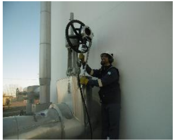
Bloqueo de equipo para mantenimiento
