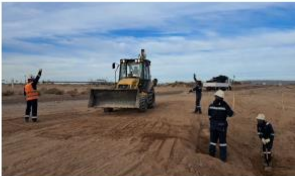
Detención de tareas. Identificación de pérdida de hidráulico.
