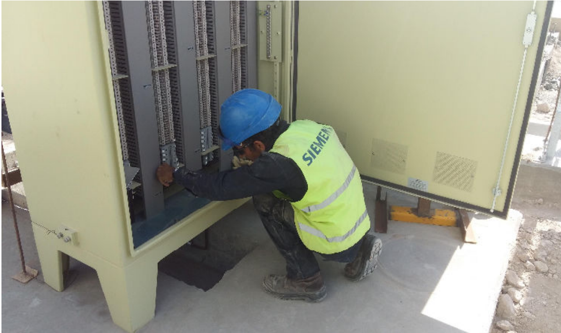
Foto 11: Conexiones en tablero de comando de reactores de 500 KV.
