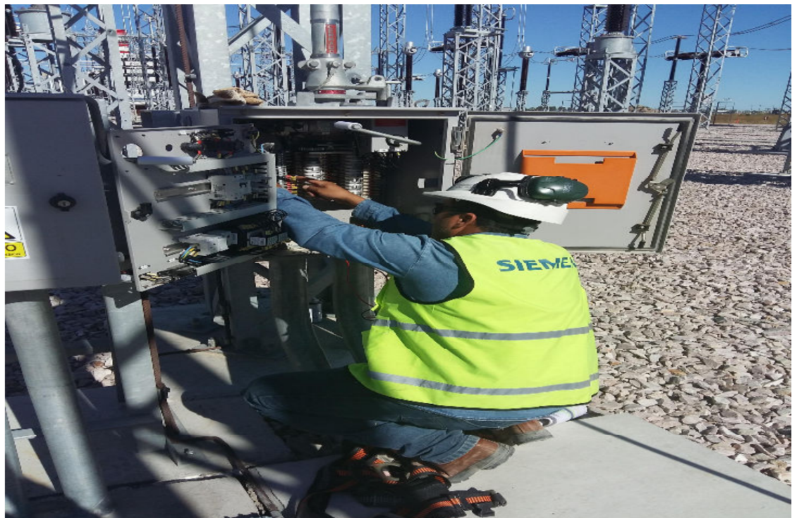
Foto 10: Conexiones en tablero de comando de seccionadores.
