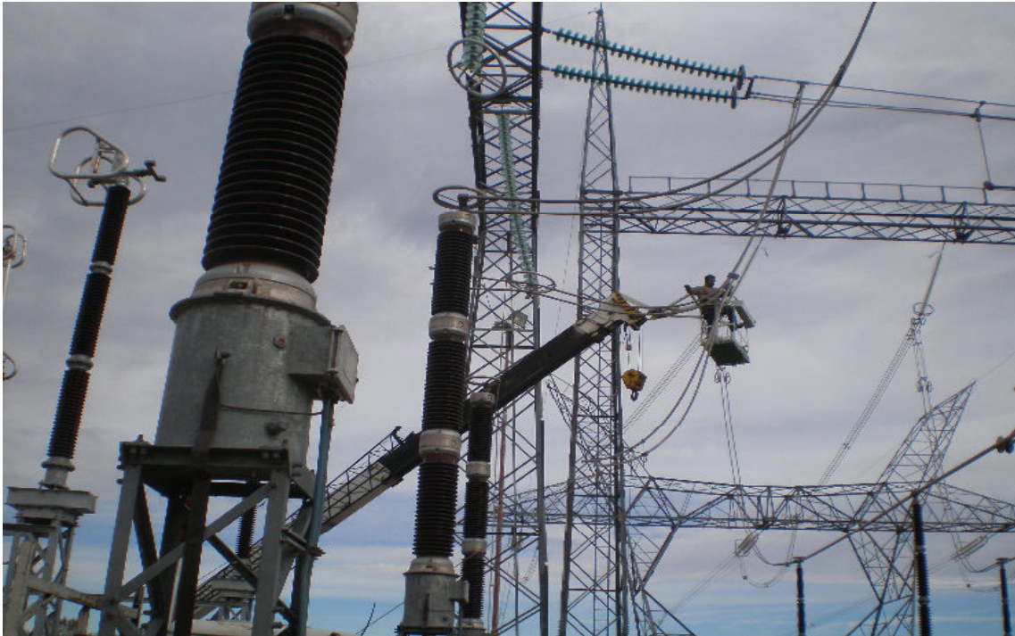
Foto 15: Conectado y bajada de línea 500 KV a descargador.
