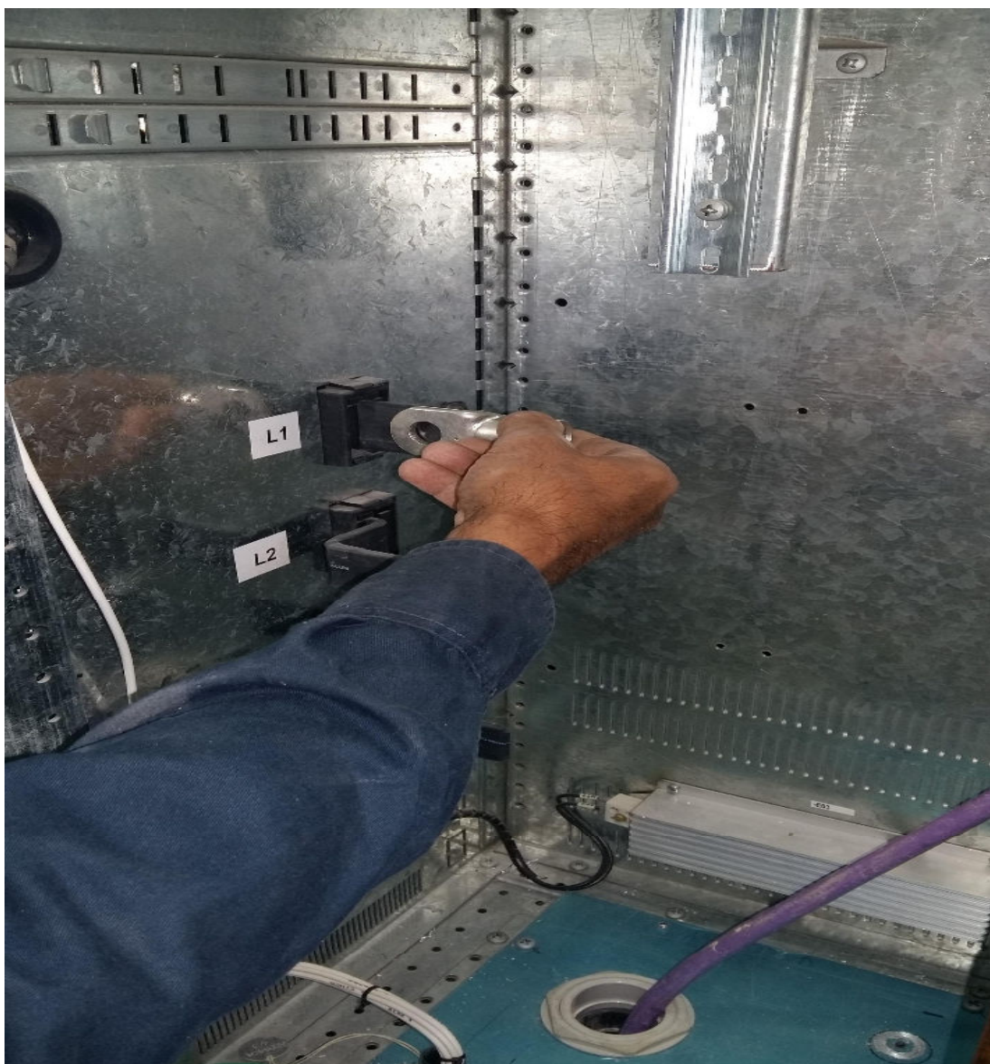
Foto 8: Posicionamiento de terminal.
