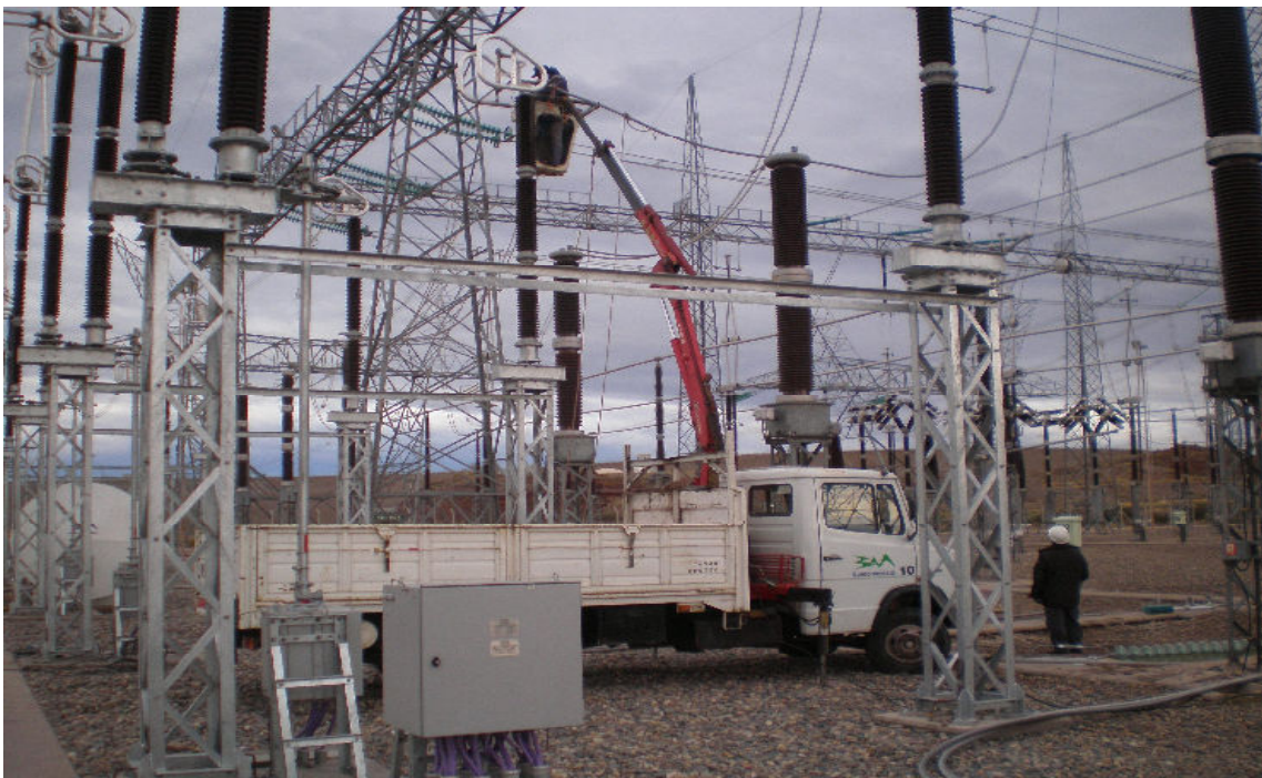
Foto 16: Conectado de seccionador.
