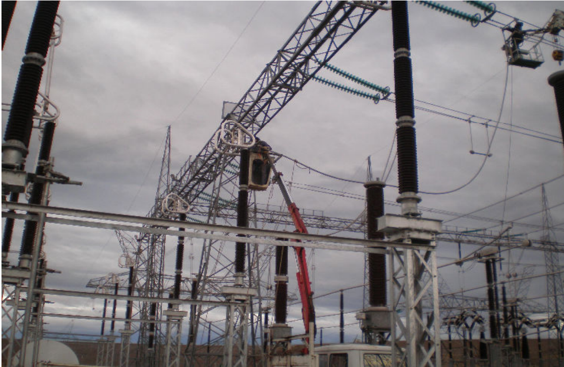
Foto 17: Bajada de línea 500 KV a seccionador.
