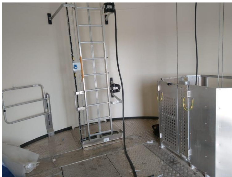
Aerogenerador por dentro. Se visualiza escalera y parte del ascensor.
