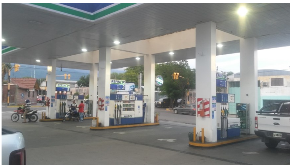
Desniveles identificados en Islas de despacho
