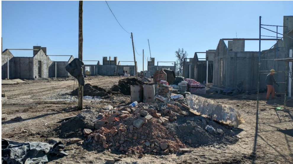
Imagen 3.5.1 Falta de orden y limpieza
