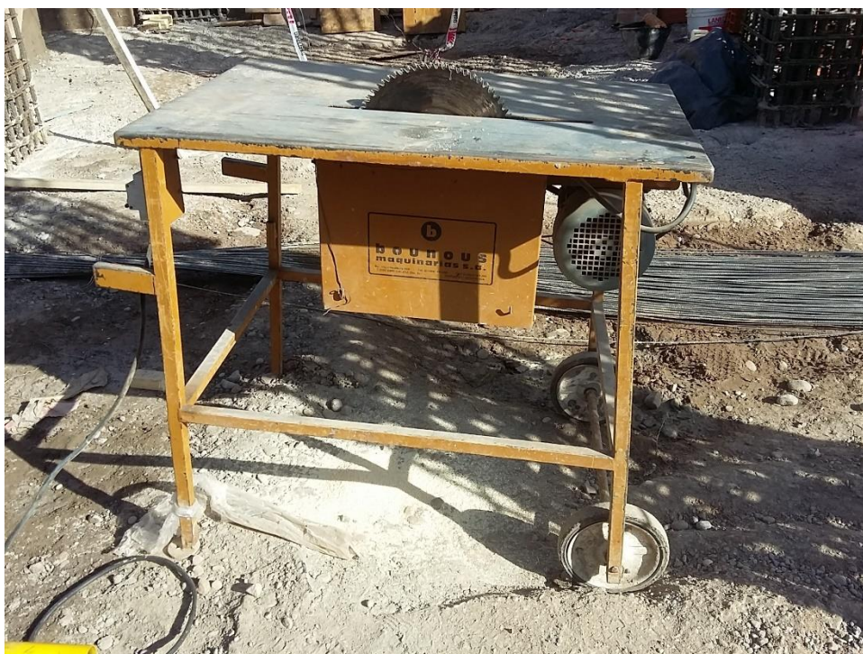
Imagen 3.3.1 desvío de seguridad – maquina sin resguardos
