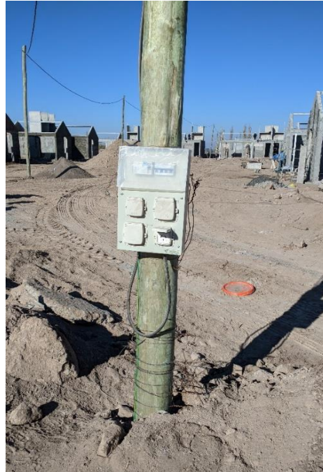
Imagen 4.11 tableros eléctricos provisionales
