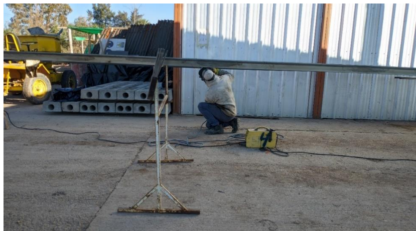
Imagen 3.8 riesgo de proyección de partículas
