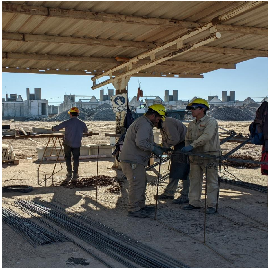
Imagen 3.3 riesgo de cortes con objetos
