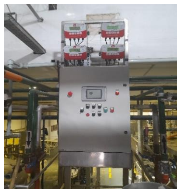
Ilustración 9: Tablero de Control
